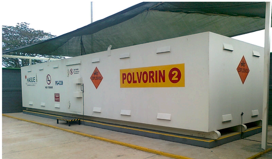
Polvorín metálico con anclaje a piso
